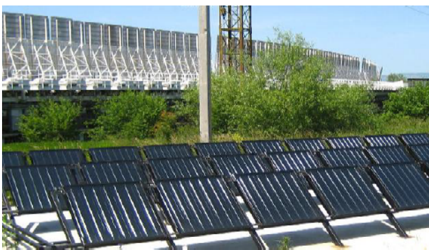
Рисунок 2.8 – Установка солнечного горячего водоснабжения гостиницы РАТАН
