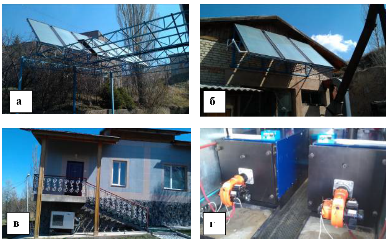
Рисунок 2.2 – Вновь созданные энергетические установки
